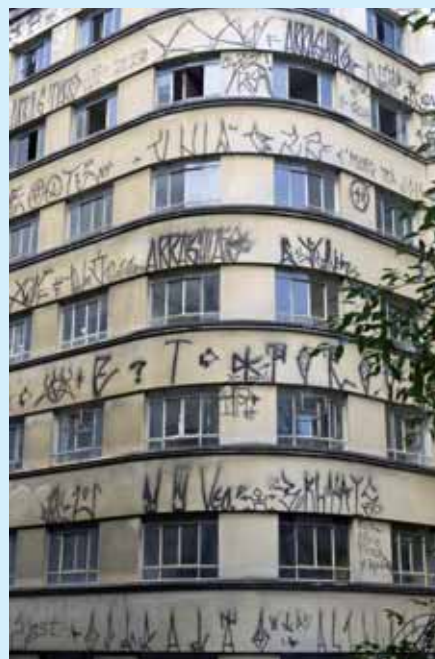
Fachada de edifício abandonado da Rua Barão de Itapetininga, no centro da cidade de São Paulo.
